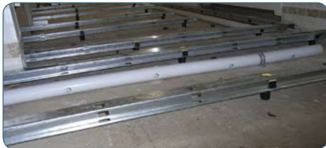
Granabsystemet med tillhörande ventilationssystem sett från sidan.
